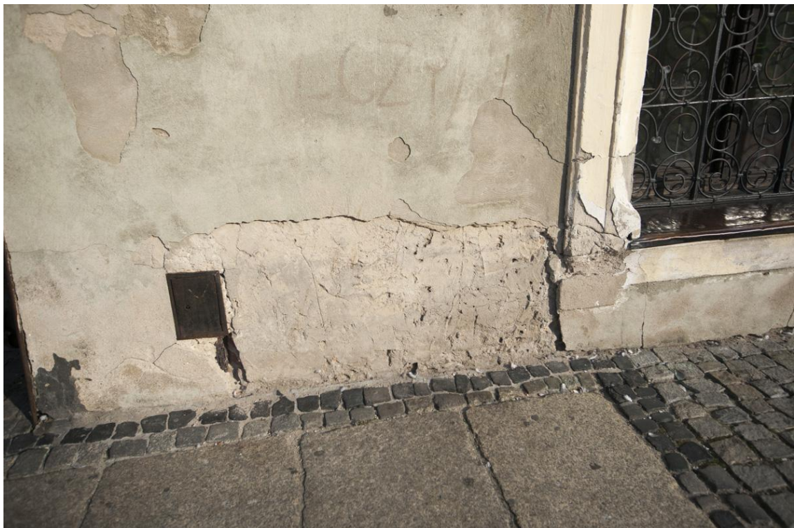
Ubytki tynku w elewacji frontowej
