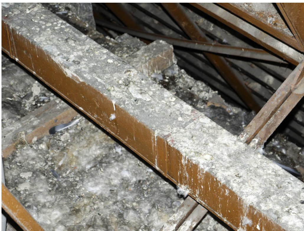
Fragment konstrukcji dachu – pokryty warstwą ptasich odchodów
