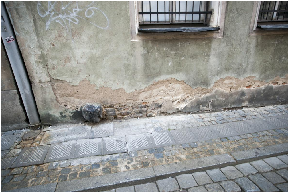
Degradacja partii cokołowej od ul. Klasztornej
