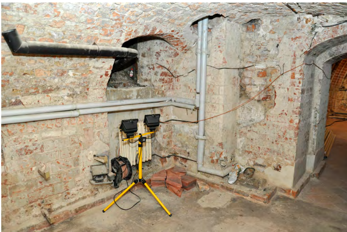
Fot. 10 Stary Ratusz w Poznaniu. Pomieszczenia ekspozycyjne piwnic. Pomieszczenie 103. Widoczna różnorodność wątków w obrębie ścian i sklepienia oraz liczne instalacje i przekucia instalacyjne.
