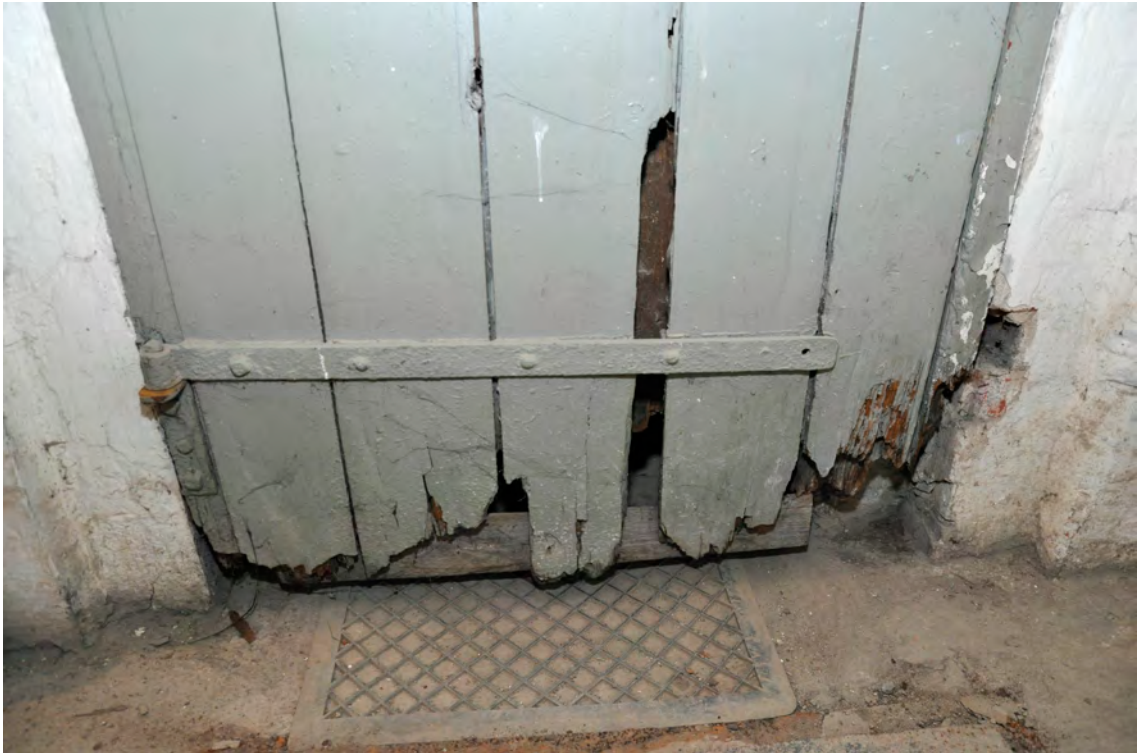
Fot. 34 Stary Ratusz w Poznaniu. Dolna kondygnacja piwnic. Drewniane drzwi do pomieszczenia 09. Widoczna daleko posunięta degradacja drewna.
