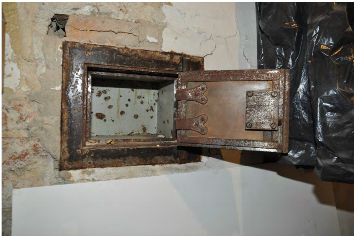
Fot. 9 Stary Ratusz w Poznaniu. Pomieszczenia ekspozycyjne piwnic. Pomieszczenie 102. Widoczne zniszczenia tynków i skorodowany sejf wtórnie wmurowany w ścianę.
