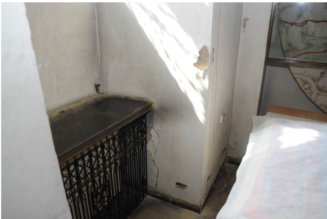
Fot. 22 Stary Ratusz w Poznaniu. Pomieszczenia ekspozycyjne piwnic. Pomieszczenie 106. Widoczne zniszczenia w obrębie wentylowanych tynków dystansowych na ścianie zewnętrznej.
