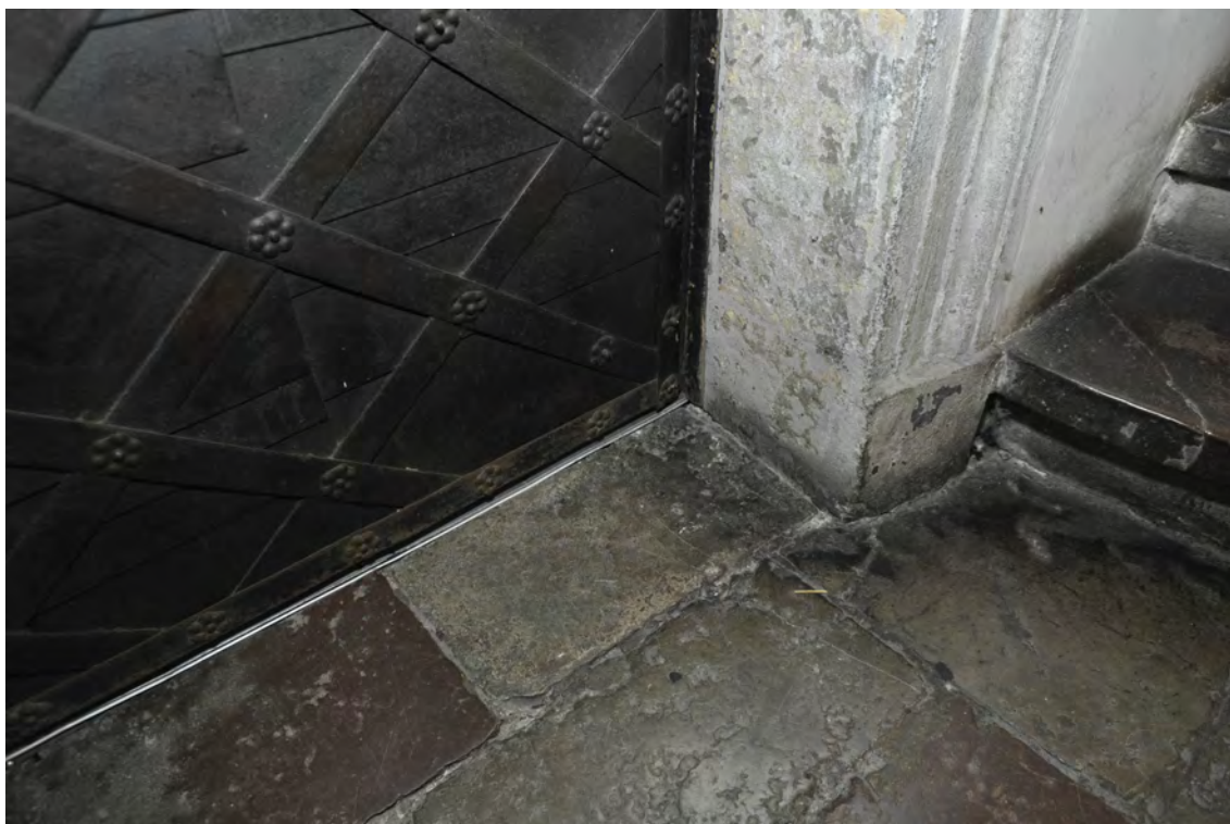
Fot. 6 Stary Ratusz w Poznaniu. Pomieszczenie 201 parteru. Drzwi do pomieszczenia pod schodami. Widoczne uzupełnienia ubytków kamiennego węgara zaprawą oraz korozja blach okucia drzwi.
