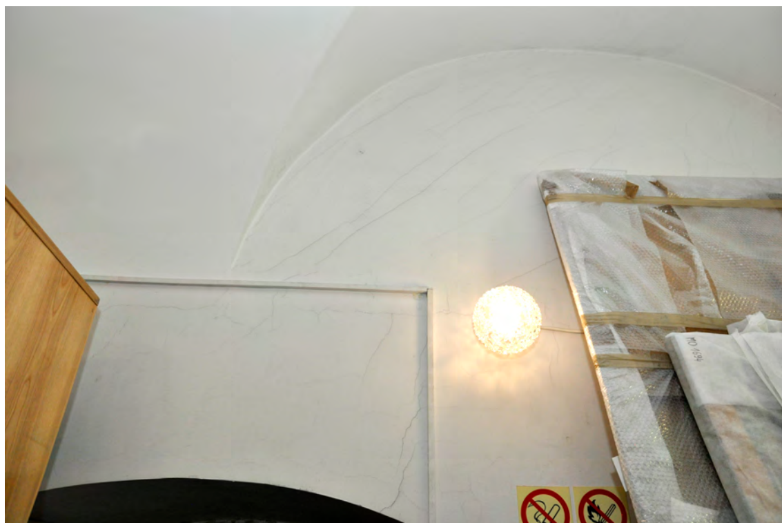
Fot. 4 Stary Ratusz w Poznaniu. Pomieszczenie 204 parteru. Widoczne spękania tynków świadczą o problemach zaistniałych w przeszłości z podłożem.
