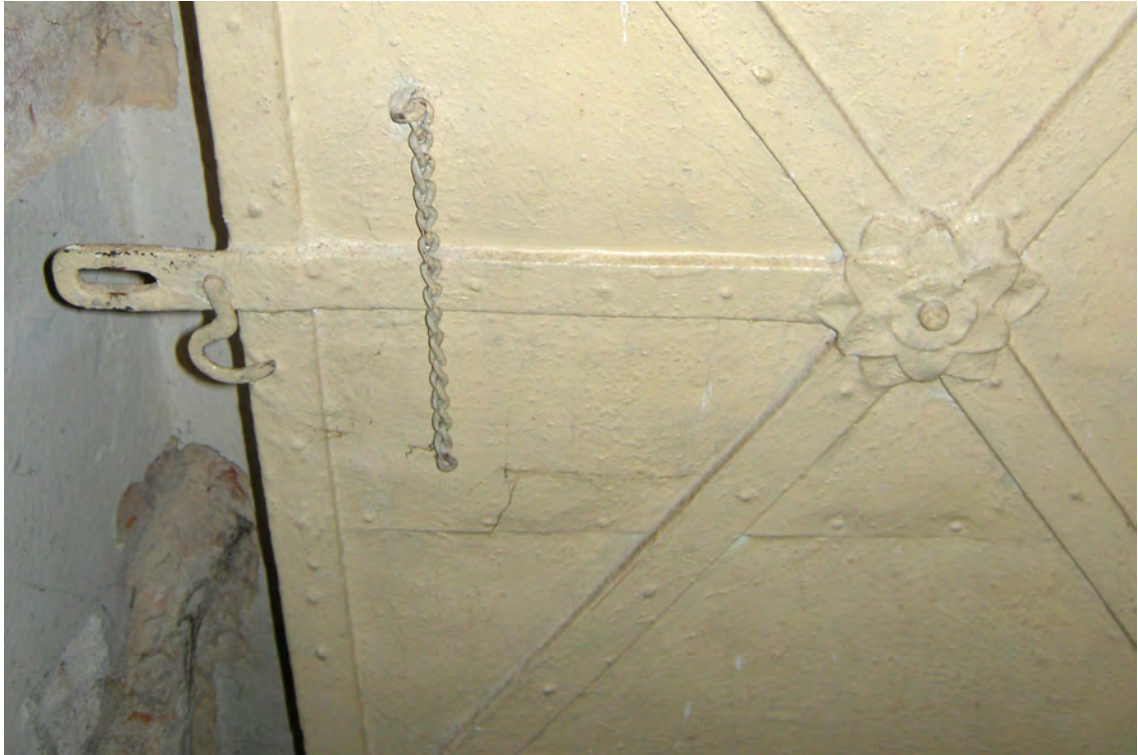
Fot. 29 Stary Ratusz w Poznaniu. Pomieszczenia magazynowe piwnic. Metalowe drzwi w pomieszczeniu 114. Widoczne nawarstwienia powłok malarskich powodujące ztracanie się formy detalu kowalskiego.
