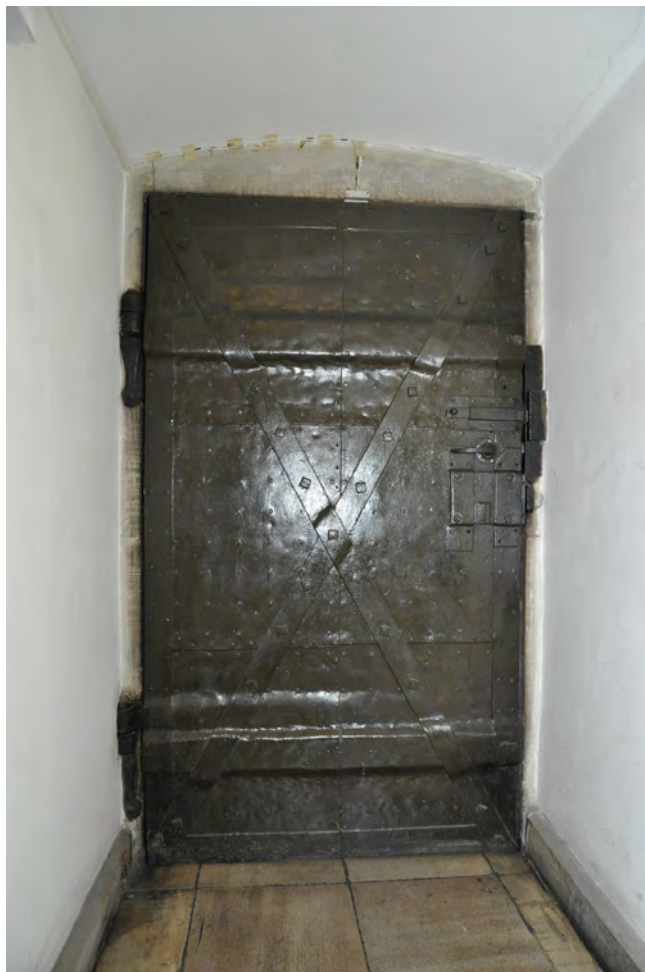
Fot. 3 Stary Ratusz w Poznaniu. Drzwi z pomieszczenia 204 do 203 parteru. Widoczne pęknięte kamienne nadproże, spękanie tynku na sklepieniu glifu drzwiowego oraz korozja blachy w dolnej partii okucia.
