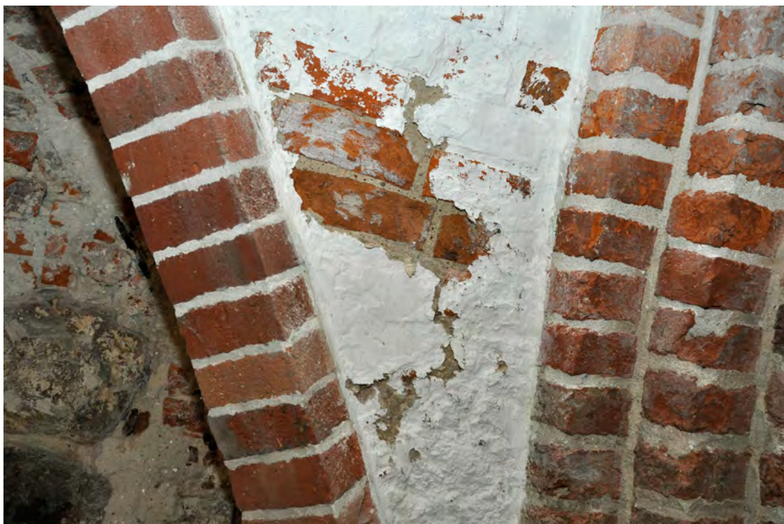
Fot. 15 Stary Ratusz w Poznaniu. Pomieszczenia ekspozycyjne piwnic. Pomieszczenie 105. Widoczne zniszczenia pobiał spowodowane krystalizacją soli w obrębie pachy sklepiennej.
