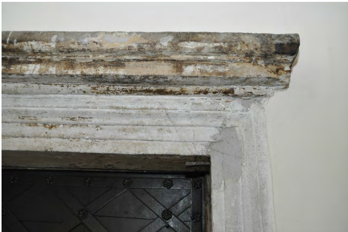
Fot. 5 Stary Ratusz w Poznaniu. Pomieszczenie 201 parteru. Drzwi do pomieszczenia pod schodami. Widoczne prowizoryczne wzmocnienie pękniętego nadproża skorodowanym elementem stalowym, nieestetyczne kity oraz przebarwienia i zabrudzenia powierzchni kamienia.
