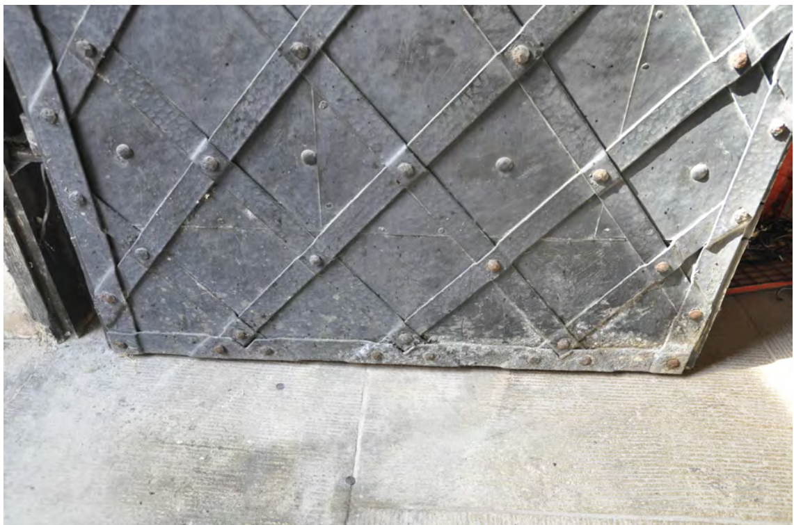
Fot. 24 Stary Ratusz w Poznaniu. Pomieszczenia piwnic. Drzwi zewnętrzne z klatki schodowej (pomieszczenie 110). Widoczne ogniska korozji, pojawiające się miejscowo w dolnej partii okucia.
