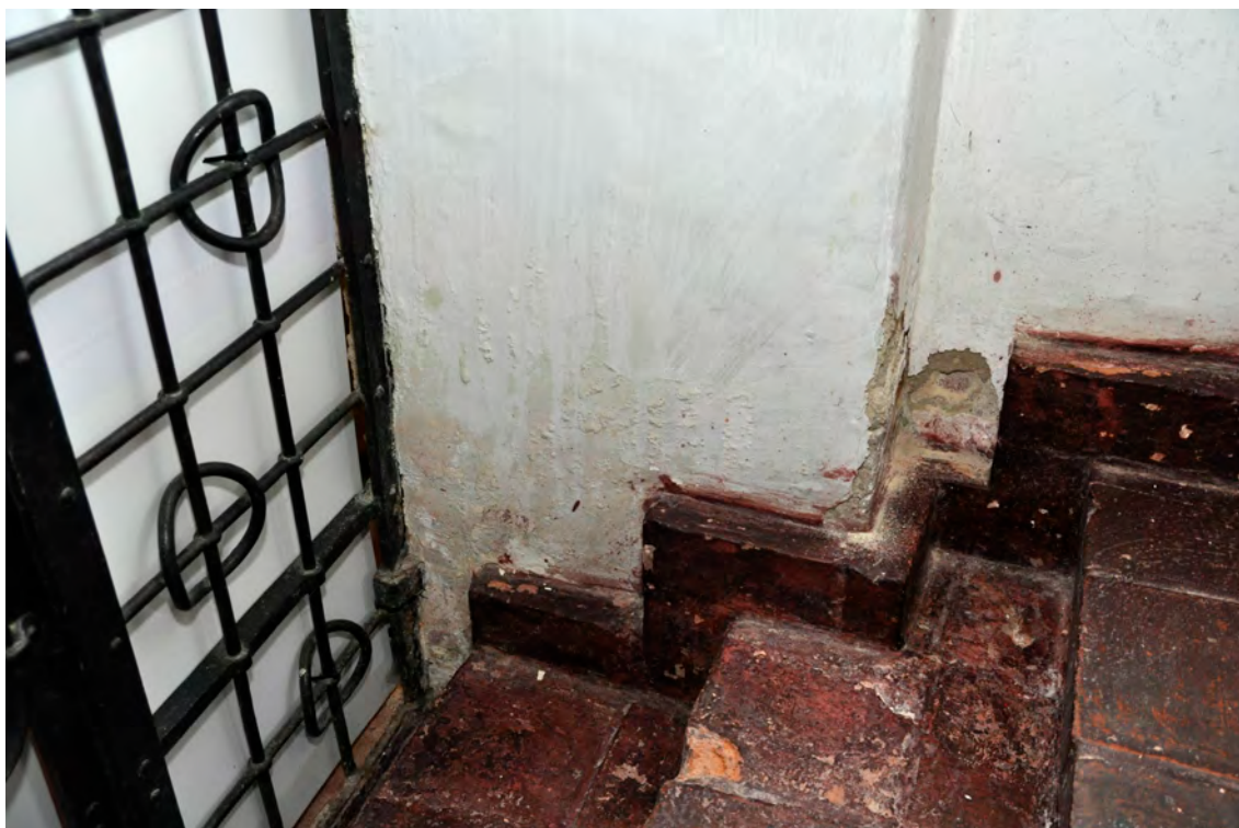
Fot. 7 Stary Ratusz w Poznaniu. Pomieszczenia ekspozycyjne piwnic. Pomieszczenie 101. Widoczne zniszczenia tynku oraz ceramicznej okładziny schodów spowodowane zawilgoceniem muru.
