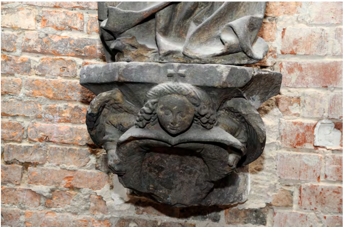
Fot. 36 Stary Ratusz w Poznaniu. Kamienne elementy ekspozycyjne. Madonna z Dzieciątkiem (nr inw. MNP DA 49). Dolna część. Widoczna ciemna fałszywa patyna pochodzenia atmosferycznego, zaplamienia i przebarwienia oraz ubytki kamienia.
