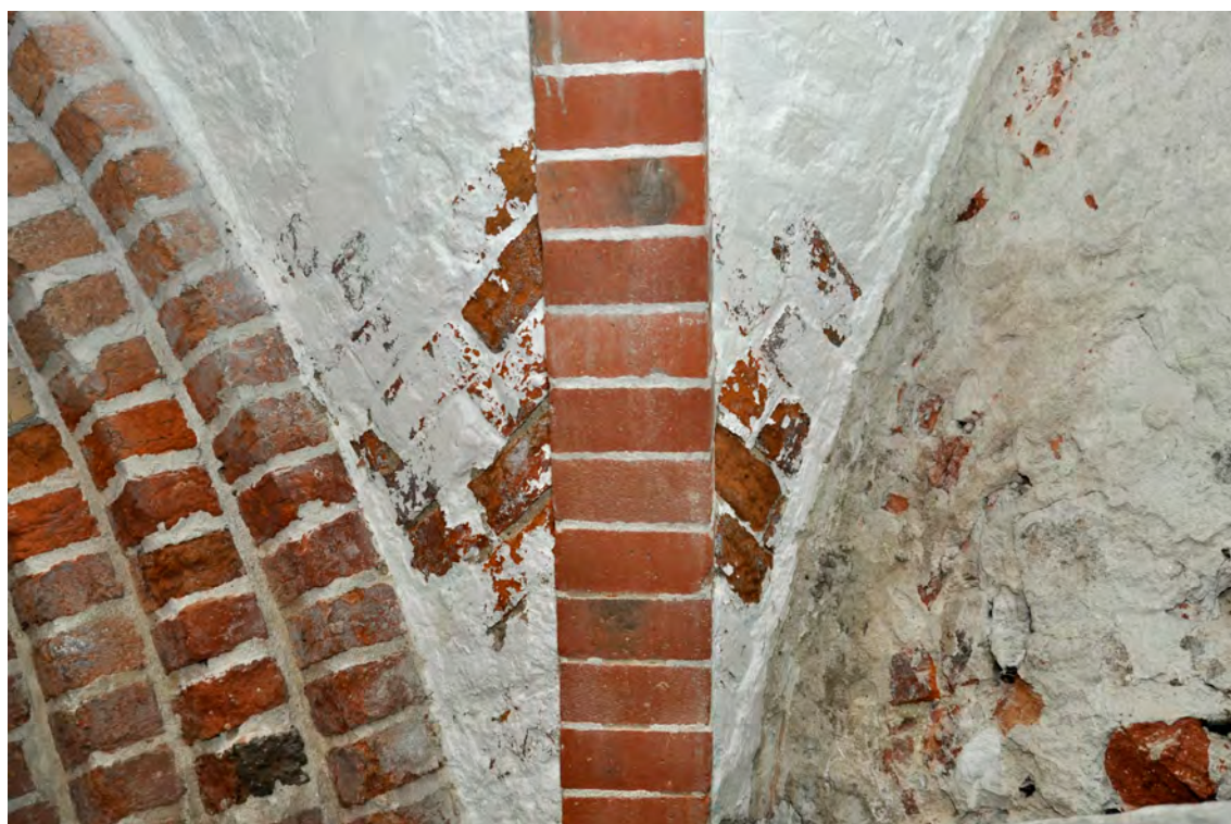
Fot. 18 Stary Ratusz w Poznaniu. Pomieszczenia ekspozycyjne piwnic. Pomieszczenie 107. Widoczne zniszczenia pobiał spowodowane krystalizacją soli w obrębie pachy sklepiennej.
