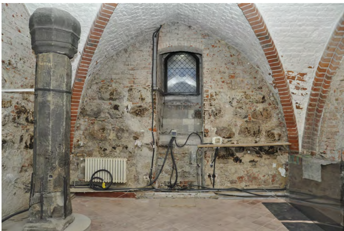
Fot. 16 Stary Ratusz w Poznaniu. Pomieszczenia ekspozycyjne piwnic. Pomieszczenie 107. Widoczne przemurowania wątków, ubytki i zniszczenia cegieł, przekucia i bruzdy instalacyjne, zabrudzenia powierzchni, przesycenie substancją bitumiczną.
