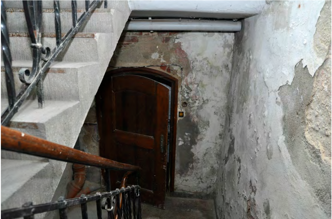
Fot. 31 Stary Ratusz w Poznaniu. Dolna kondygnacja piwnic. Klatka schodowa 01. Widoczna destrukcja tynków na ścianach zewnętrznych.
