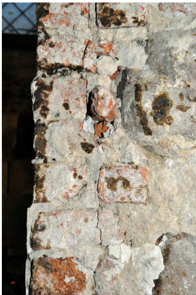
Fot. 17 Stary Ratusz w Poznaniu. Pomieszczenia ekspozycyjne piwnic. Pomieszczenie 107. Widoczne pęknięcie muru, zniszczenia cegieł, zamurowane instalacje, pozostałości tynków i przebarwienia substancją bitumiczną.
