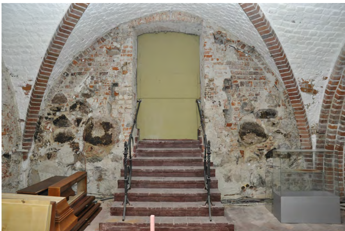
Fot. 14 Stary Ratusz w Poznaniu. Pomieszczenia ekspozycyjne piwnic. Pomieszczenie 105. Widoczne przemurowania wątków, ubytki i zniszczenia cegieł, przekucia i bruzdy instalacyjne, zabrudzenia powierzchni, przesycenie substancją bitumiczną.
