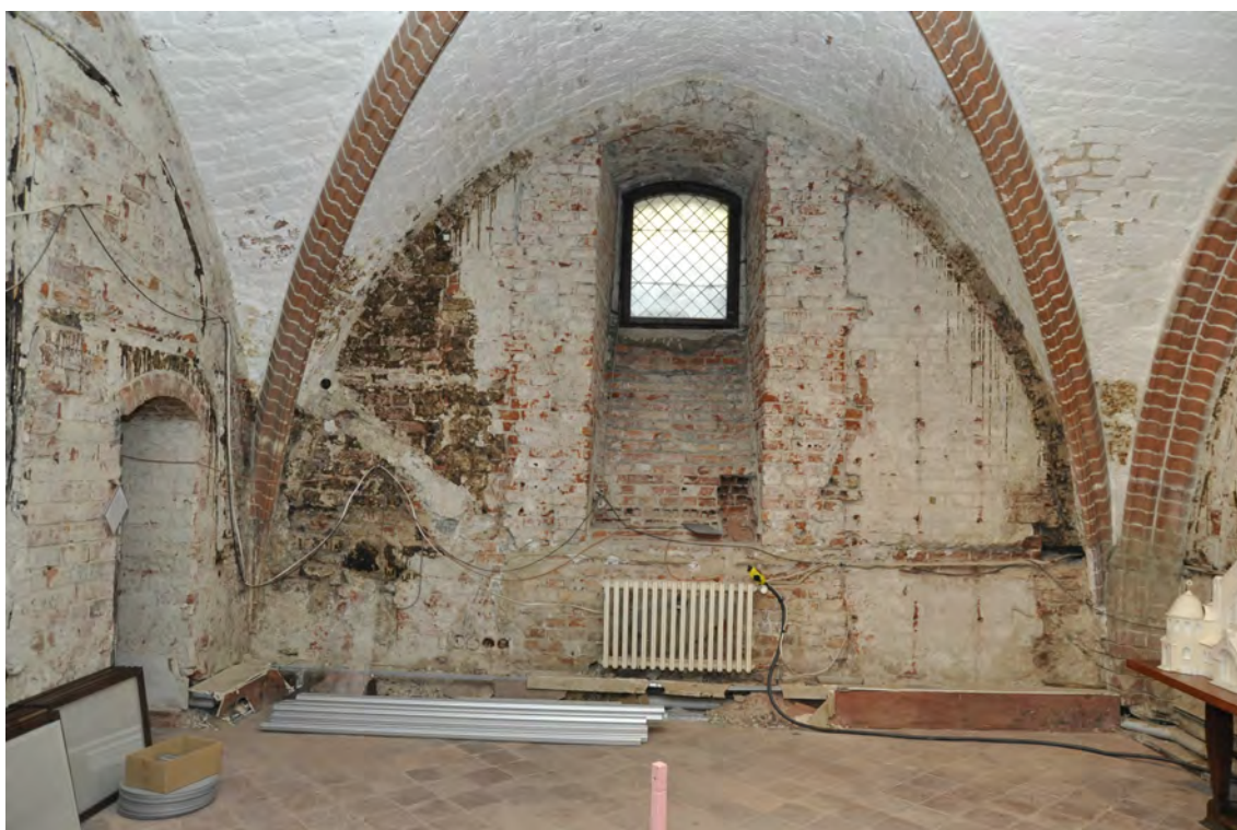
Fot. 12 Stary Ratusz w Poznaniu. Pomieszczenia ekspozycyjne piwnic. Pomieszczenie 104. Widoczne przemurowania wątków, ubytki i zniszczenia cegieł, przekucia i bruzdy instalacyjne, zabrudzenia powierzchni, przesycenie substancją bitumiczną.
