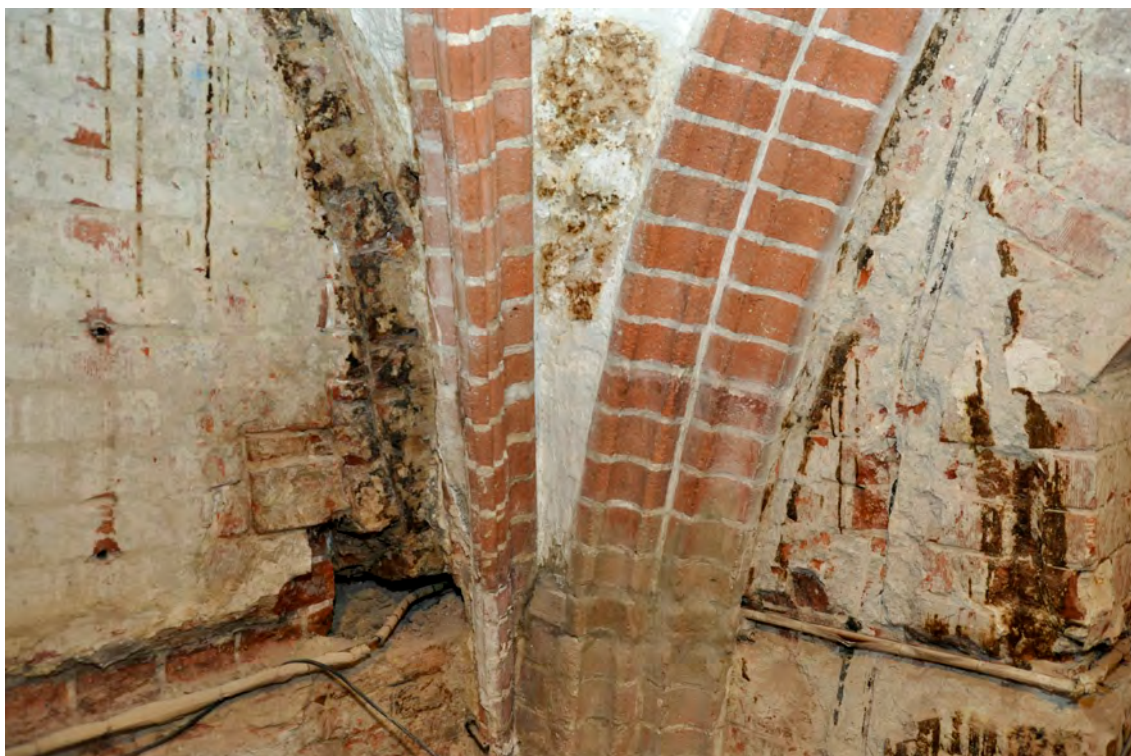
Fot. 13 Stary Ratusz w Poznaniu. Pomieszczenia ekspozycyjne piwnic. Pomieszczenie 104. Widoczne ubytki i zniszczenia cegieł, przekucia i bruzdy instalacyjne, niestaranne uzupełnienia w obrębie łuków, zabrudzenia powierzchni, pozostałości zapraw, przesycenie substancją bitumiczną.
