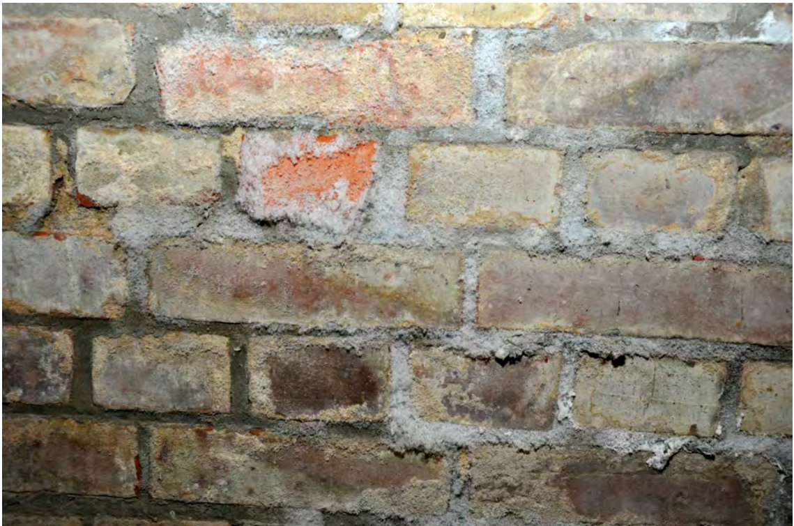
Fot. 32 Stary Ratusz w Poznaniu. Dolna kondygnacja piwnic. Zasolenia widoczne na współczesnych ścianach piwnic, znajdujących się poza obrysem ratusza.
