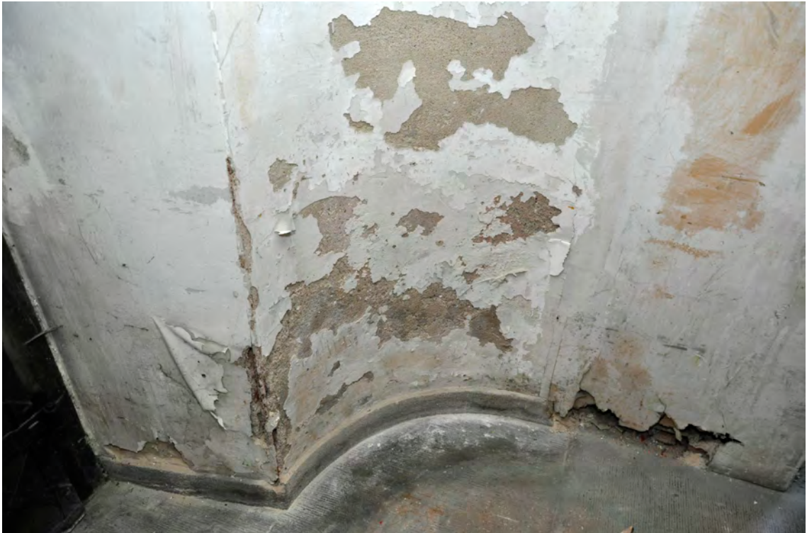
Fot. 26 Stary Ratusz w Poznaniu. Pomieszczenia piwnic. Klatka schodowa (pomieszczenie 110). Widoczne zniszczenia ściany tynkowanej, związane z przenikaniem wód opadowych na skutek wadliwego systemu odprowadzania wody z płyty rynku. Skorodowało również wzmocnienie narożnika ściany.
