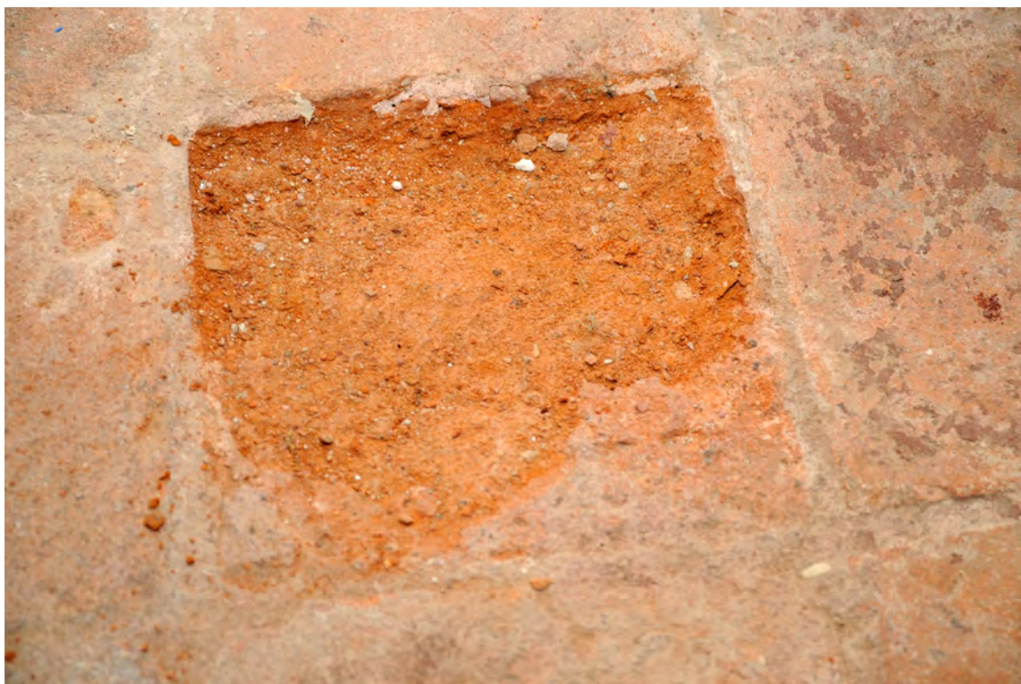
Fot. 20 Stary Ratusz w Poznaniu. Pomieszczenia ekspozycyjne piwnic. Pomieszczenie 108. Widoczne zniszczenia współczesnej, ceramicznej płyty posadzkowej.
