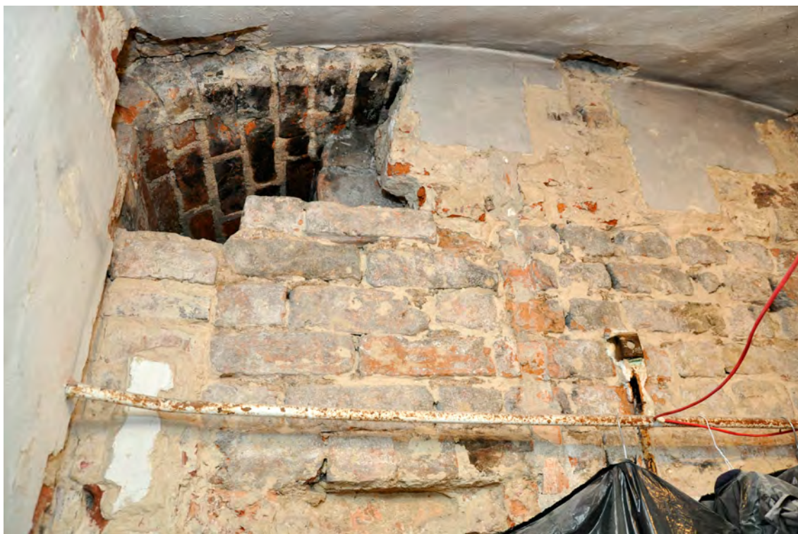
Fot. 8 Stary Ratusz w Poznaniu. Pomieszczenia ekspozycyjne piwnic. Pomieszczenie 102. Widoczna odkrywka architektoniczna, zniszczone i zabrudzone tynki oraz cegły w wątku.
