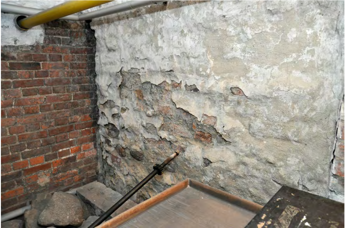
Fot. 33 Stary Ratusz w Poznaniu. Dolna kondygnacja piwnic. Widoczne zniszczenia tynków na historycznej ścianie ratusza.
