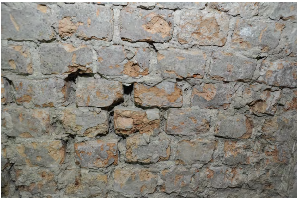
Fot. 11 Stary Ratusz w Poznaniu. Pomieszczenia ekspozycyjne piwnic. Pomieszczenie 103. Widoczne uszkodzenia mechaniczne lica cegieł, degradacja zaprawy, zabrudzenia i patyna na powierzchni.
