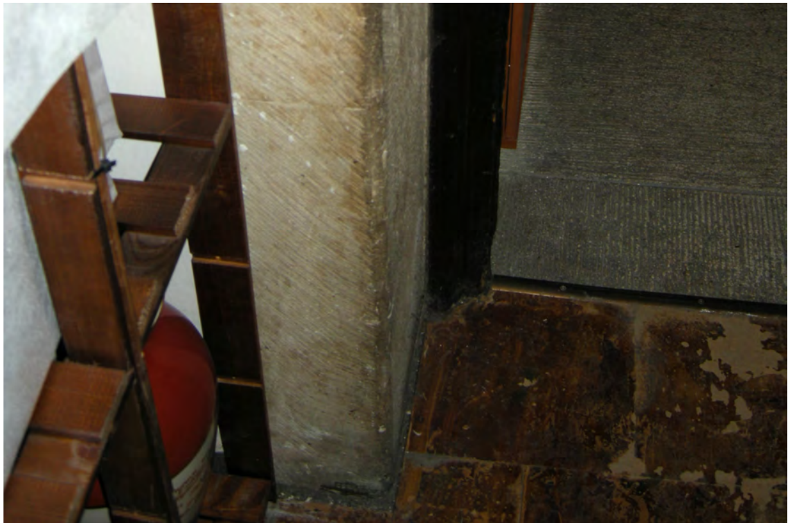
Fot. 30 Stary Ratusz w Poznaniu. Pomieszczenia magazynowe piwnic. Kamienne obramienie drzwi pomieszczenia 114. Widoczne zabrudzenia i uszkodzenia krawędzi węgara oraz posadzka ze sztucznego kamienia, zasłonięta częściowo współczesną wykładziną.
