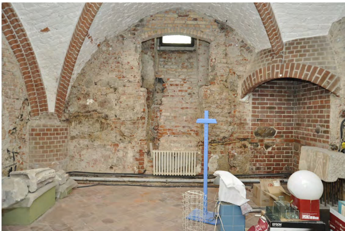
Fot. 19 Stary Ratusz w Poznaniu. Pomieszczenia ekspozycyjne piwnic. Pomieszczenie 108. Widoczne przemurowania wątków, ubytki i zniszczenia cegieł, przekucia i bruzdy instalacyjne, zabrudzenia powierzchni, przesycenie substancją bitumiczną.
